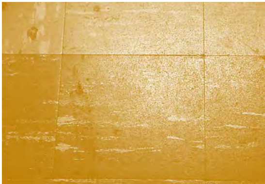
Exemple d'amiante non friable : carreaux de sol en vinyle amianté.
